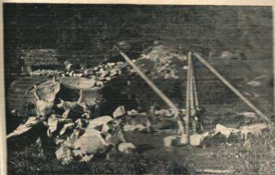
ESTRADA DE RÓDAGEM DE BORBOREMA A SERRARIA — Construção da ponte sobre o rio COMMUCÁ
