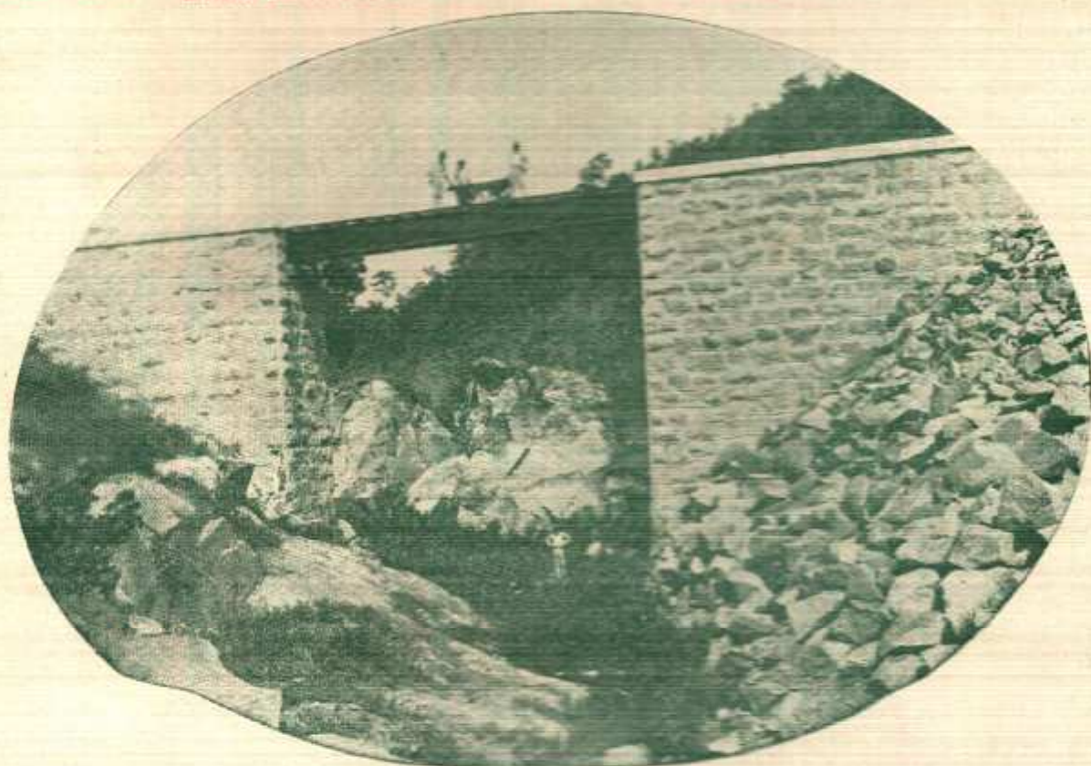
ESTRADA DE FERRO DE INDEPENDENCIA A PICUIHY — Ponte sobre o rio CAMUCÁ
